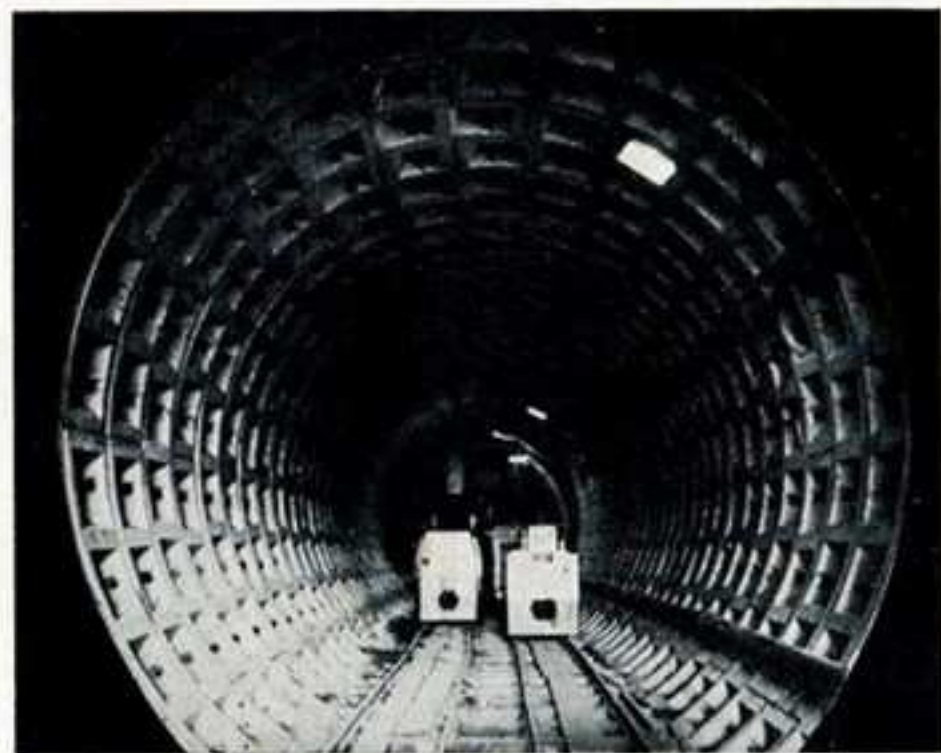
Un aspetto dei lavori per la costruzione della metropolitana di Roma, realizzati dall'Impresit
